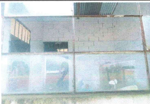
Foto 5: Se evidencia la necesidad de cambio de vidrio de las ventanas del Establecimiento Educativo .
